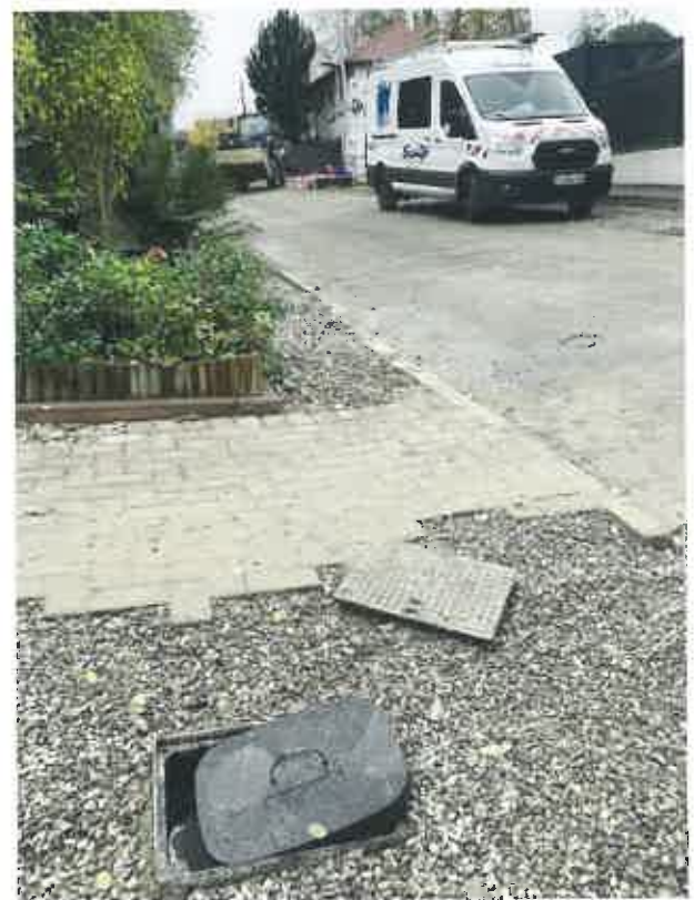
Les compteurs sont posés en limite de propriété dans un coffret isolé contre le gel.
