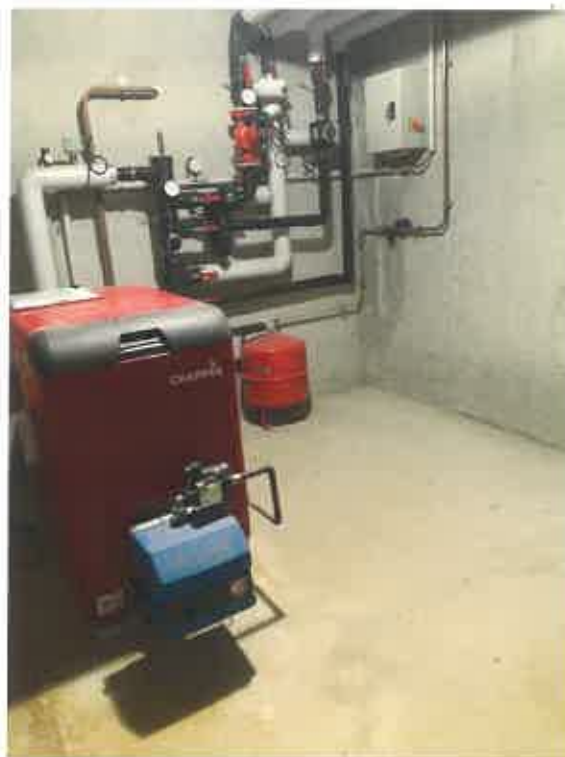
L'installation de chauffage de l'école maternelle et du site du périscolaire.
